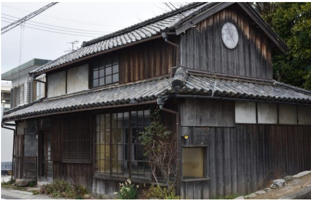
(上:荒廃した空き家)
