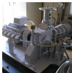
図2 沼田市浄水所発電所
