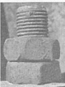
(図1:錆びたボルト)
