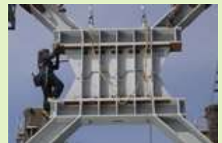
JPタワー名古屋の制振ダンパー
